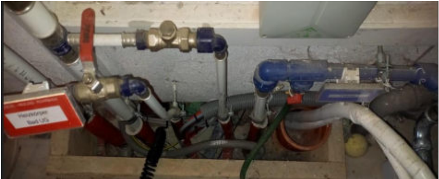
Abbildung 5: Nicht konvektionsdichte Durchführungen im Technikraum
