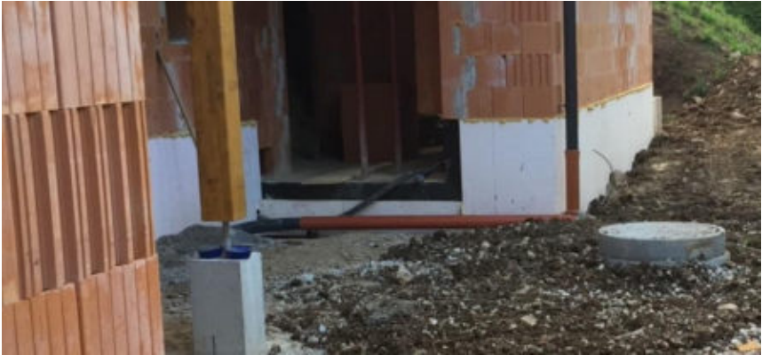
Abbildung 4: Radondrainage herausgeführt und an Fallrohr der Regenrinne angeschlossen
