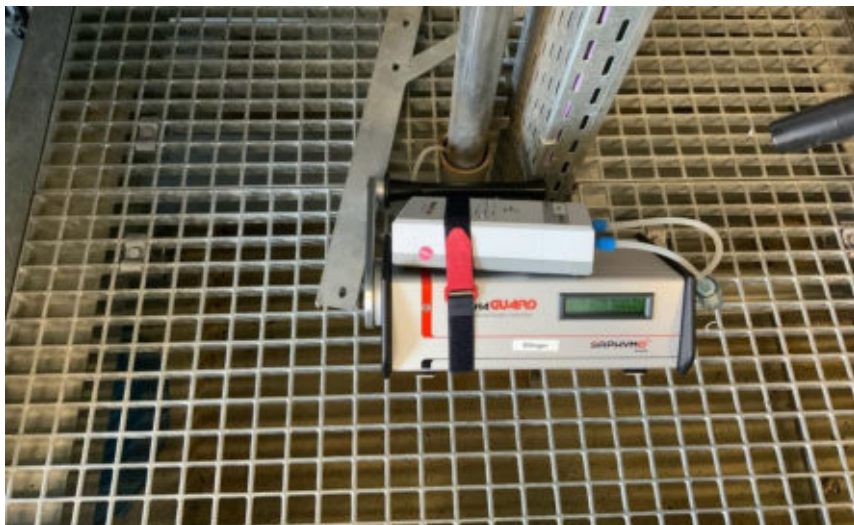
Abbildung 4: Messung an der Abluft-/Kondensatwasserleitung der Sandfilterentlüftung Messwerte bis 20.000 Bq/m 3
