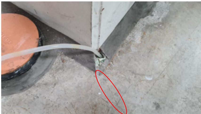
Abbildung 12: Messung der Radonbelastung im aufgeschnittenen Fugenspalt an einer Stahlstütze des Hallentragwerks. Es wurden 23.000 Bq/m 3 gemessen. In der Ellipse ein Riss in der Bodenplatte
