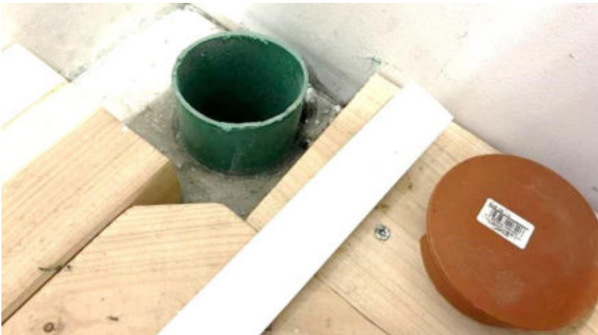
Abbildung 17: Abschlussdeckel des Steigrohres; Die Holzbohlen dienen dem Schutz der Steigrohre während der Bauphase.
