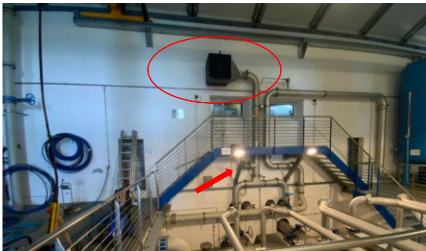
Abbildung 6: Be- und Entlüftung der Wasserkammern über einen gemeinsamen Filter (Ellipse) aus bzw. in die Halle, mit Froschklappe (Pfeil) zur Notentlüftung
