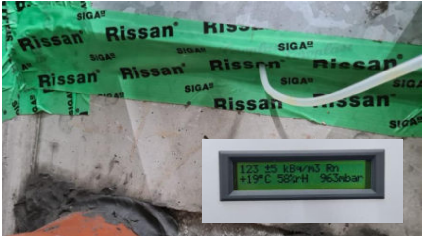
Abbildung 11: Testweise abgeklebte Trennfuge zwischen Stahlzarge und dem Bodentank. Eingefügt ist das Messergebnis nach Einführen des Messschlauchs durch Penetration der Abklebung
