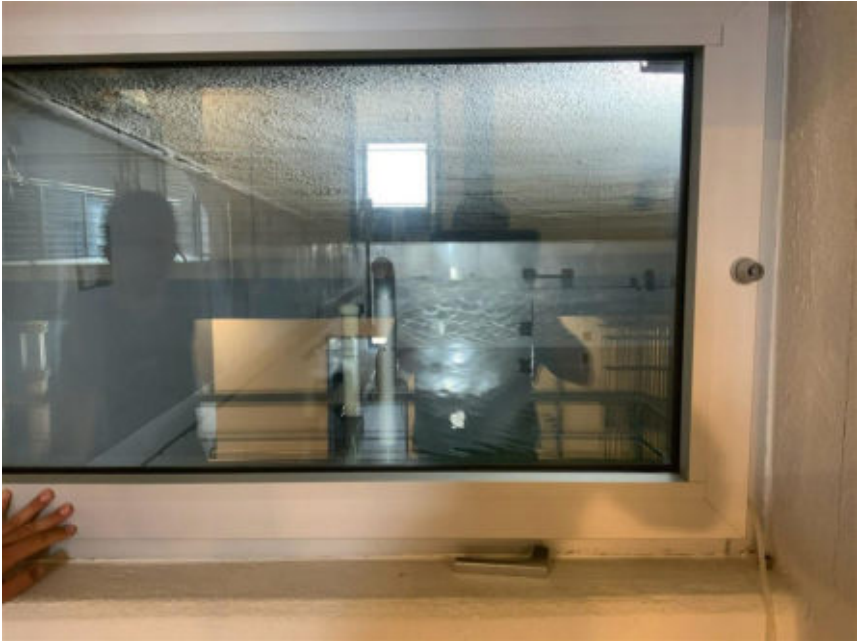
Abbildung 5: Aluminiumfenster einer Wasserkammer, Sniffing durch den fensterspalt
