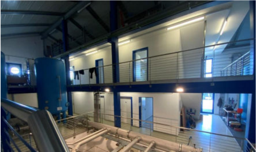
Abbildung 3: Blick aus der Halle Richtung Büro, Aufenthalts- und Betriebsräume im 1. OG – Die Räume stehen im direkten Raumluftverbund mit der Halle.
